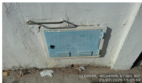
Foto 8 - Caixa do medidor de água - Hidrômetro
