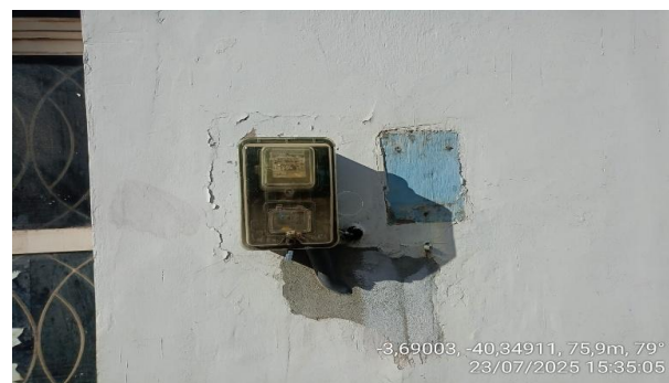
Foto 6 - Medidor de energia
