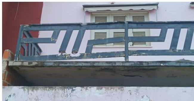
Foto 10 - Guarda-corpo em péssimo estado de conservação
