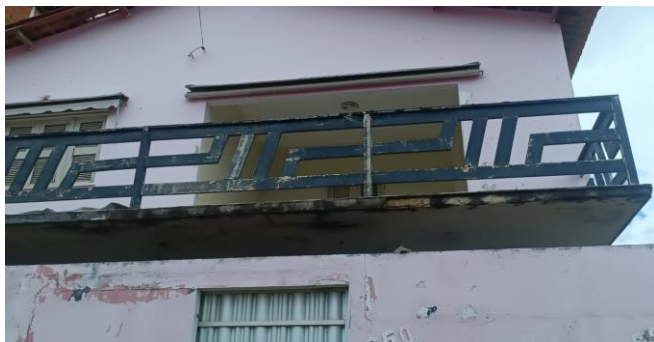
Foto 9 - Detalhes da fachada necessita de reforma
