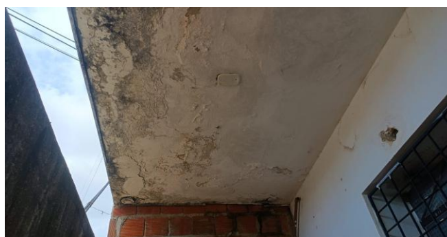
Foto 16 - Laje com infiltração
