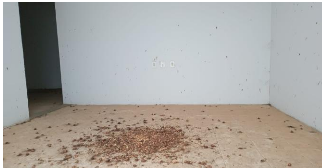
Foto 18 - Casa 01 - Casa Infestação de morcegos
