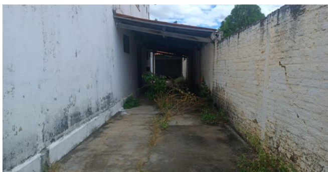
Foto 11 - Corredor lateral com mato elevado
