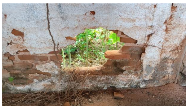
Foto 24 - Muro danificado e com risco de queda
