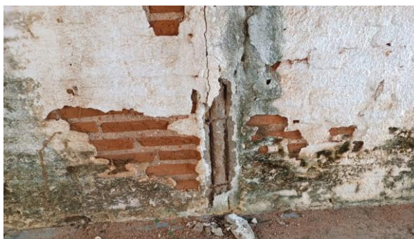
Foto 30 - Muro em péssimo estado de conservação
