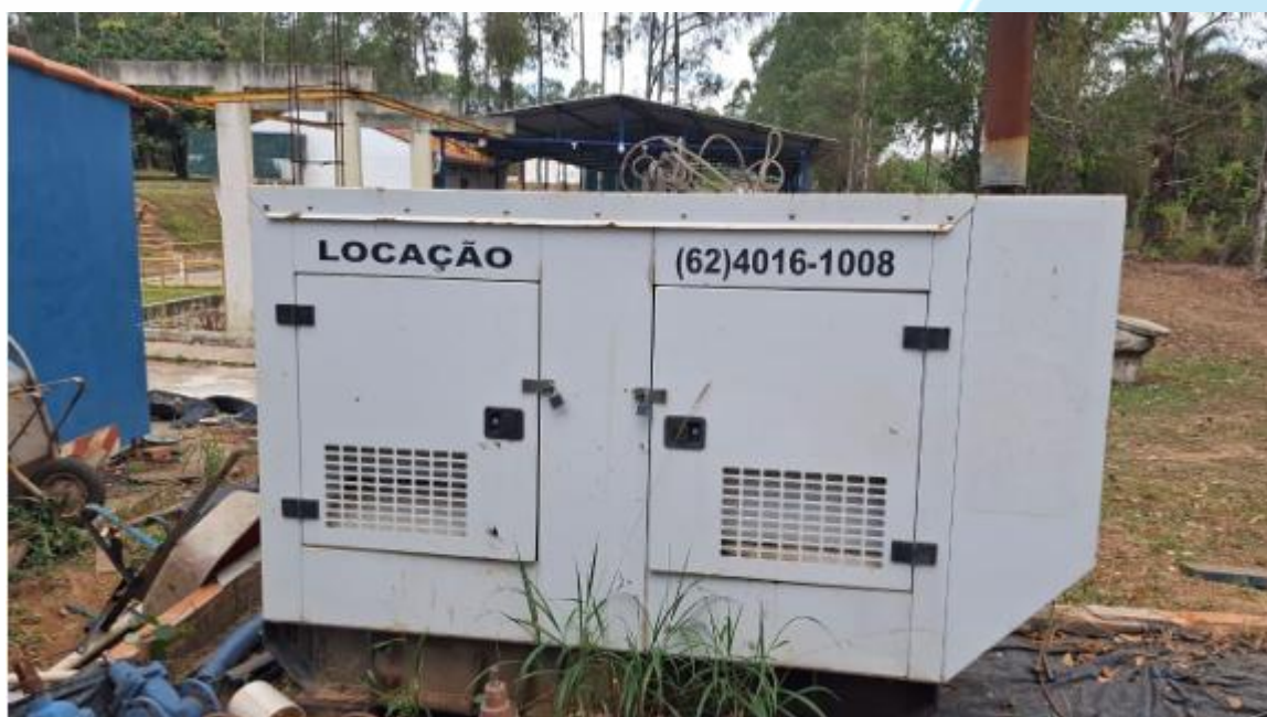
(Estação de Tratamento de Esgoto- Parque Real)
